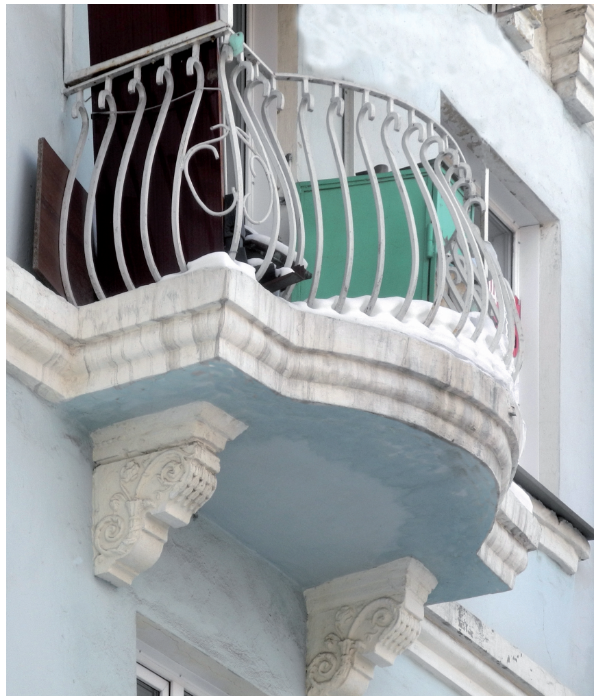
Кронштейны под балконом
