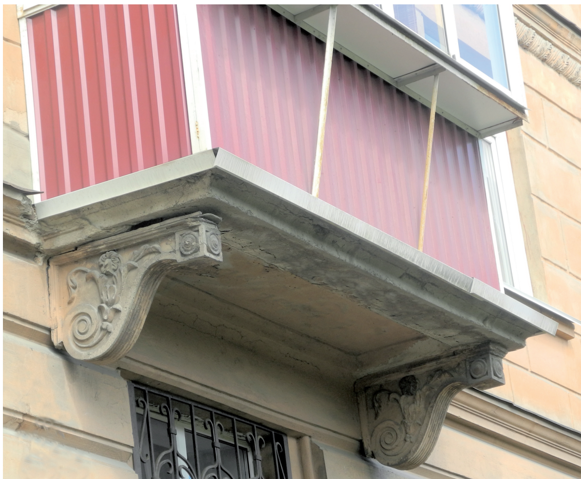
Кронштейны под балконом
