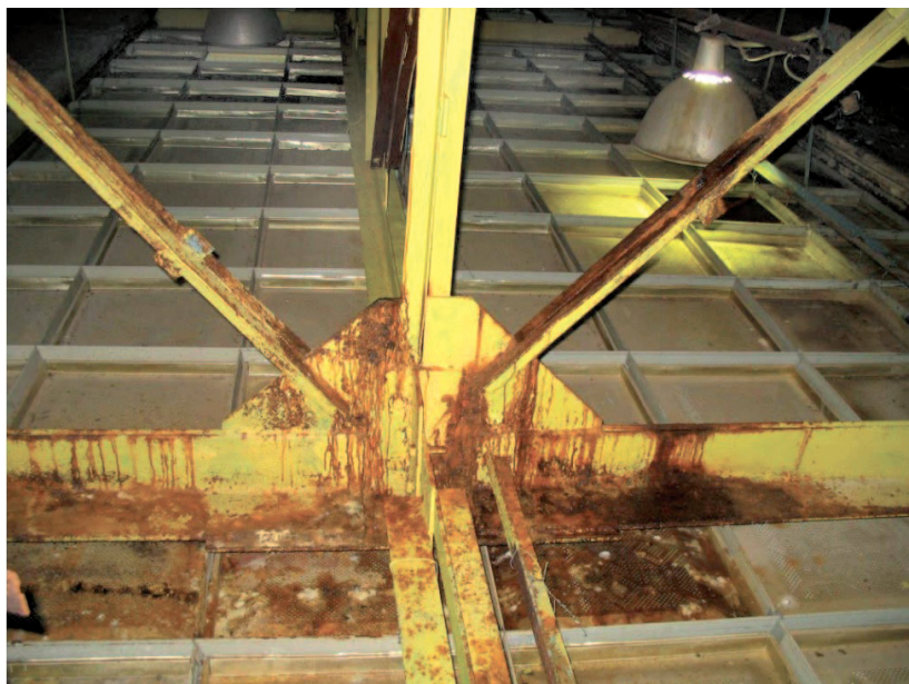
Рис. 4.3. Авария бассейна в г. Чусовой Пермской области, коррозия фермы
