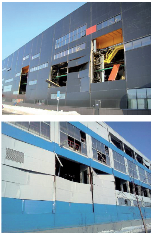
Рис. 4.11. Повреждения фасадов промышленных цехов ЧТПЗ 15 февраля 2013 г.
