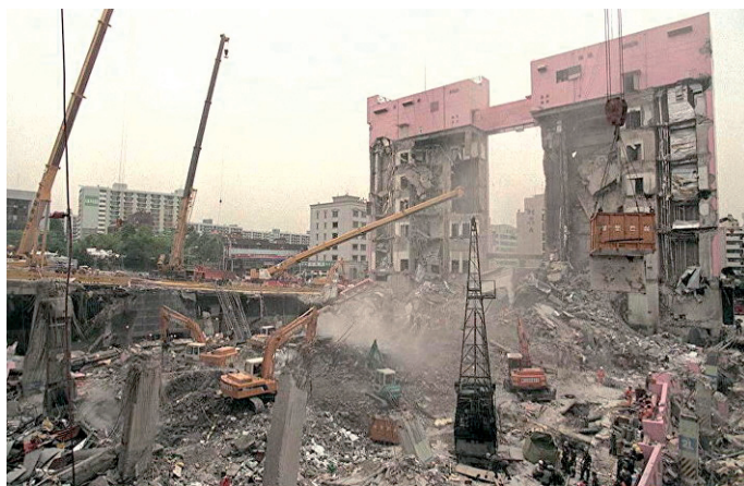
Рис. 4.12. Обрушение торгового центра в Сеуле 29.06.1995
