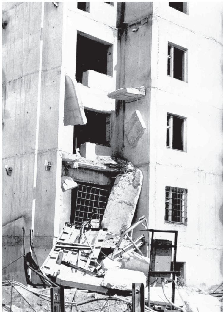
Рис. 5.3. Фрагмент обрушившихся монолитных лоджий
