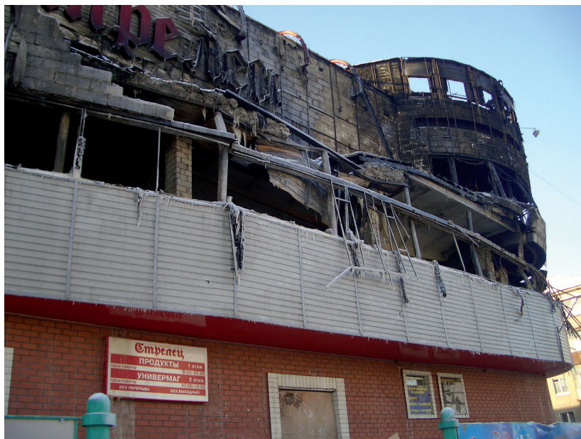
Рис. 5.5. Общий вид обрушившегося здания ТД «Стрелец»
