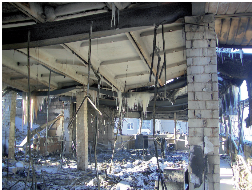
Рис. 5.6. Вид обрушившегося здания ТД «Стрелец»
