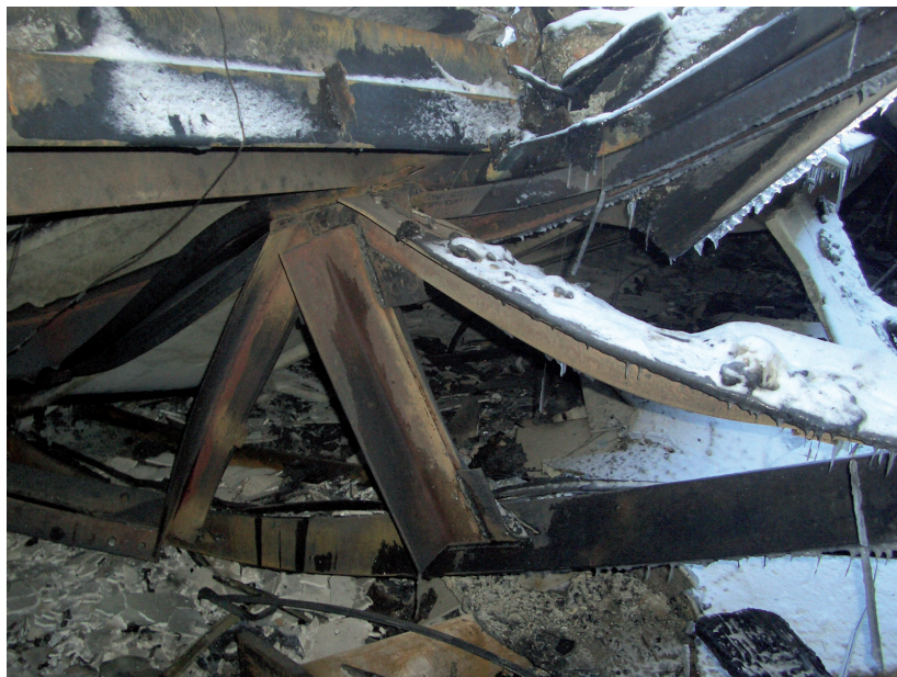
Рис. 5.7. Металлоконструкции ТД «Стрелец», подвергшиеся длительному воздействию высокой температуры
