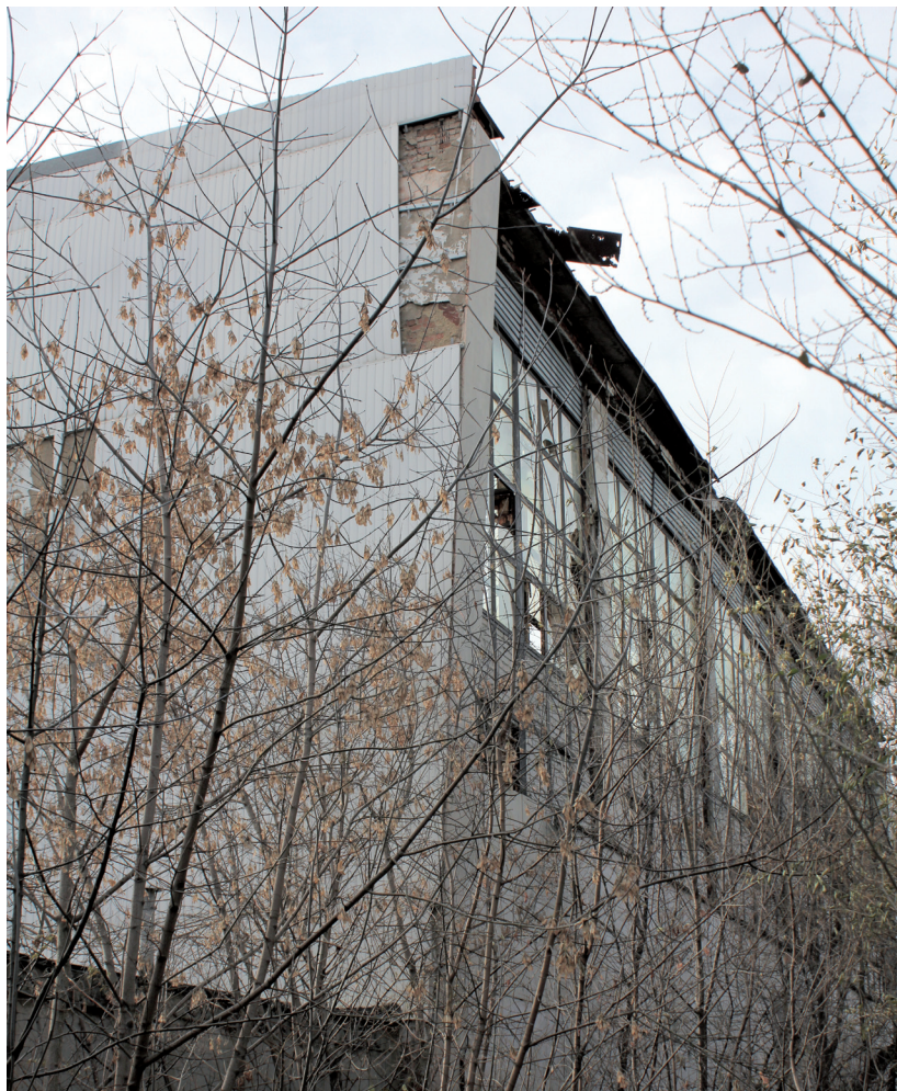
Рис. 5.8. Бассейн «Полет» после обрушения покрытия
