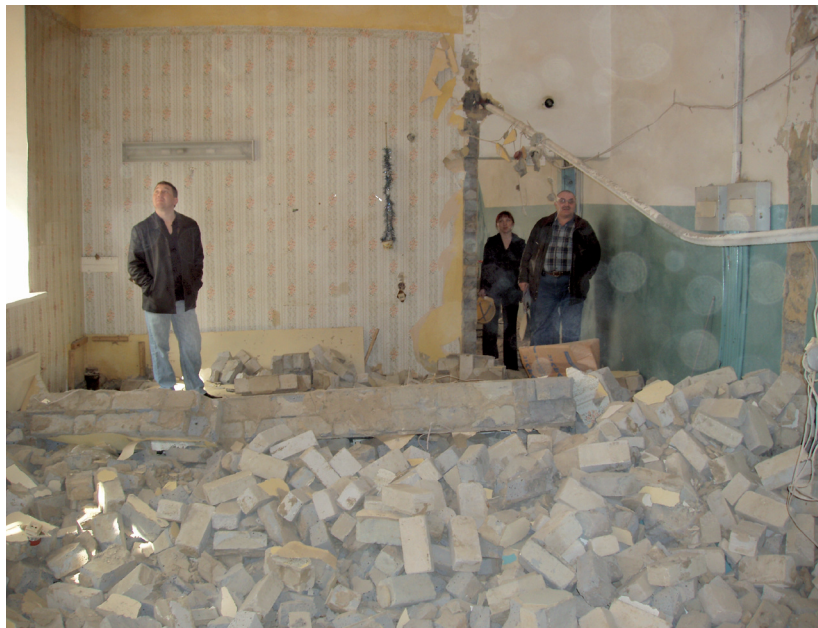
Рис. 5.9. Вид обрушившейся перегородки
