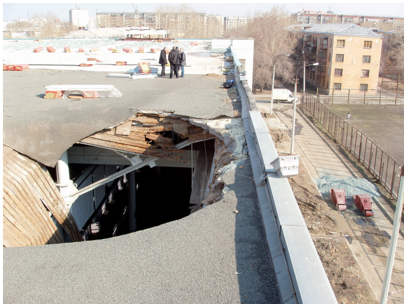
Рис. 5.11. Общий вид обрушившийся кровли спортивного сооружения
