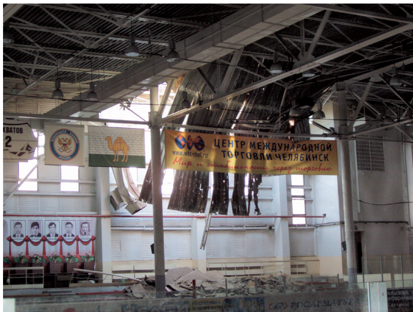
Рис. 5.14. Результат обрушения кровли в спортивном сооружении
