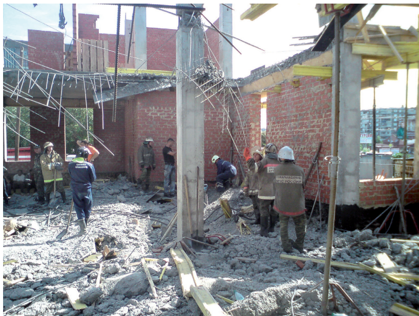
Рис. 5.15. Место обрушения перекрытия
