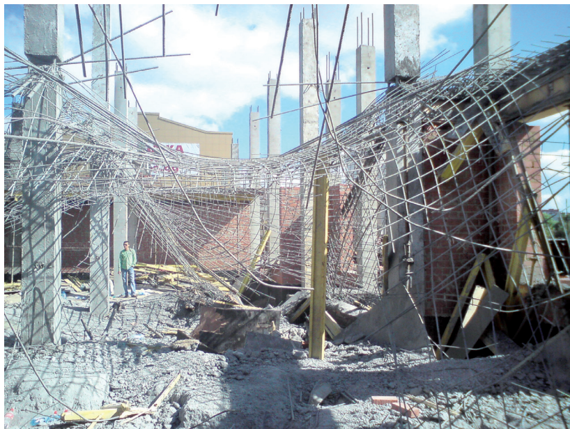
Рис. 5.18. Результат обрушения перекрытия
