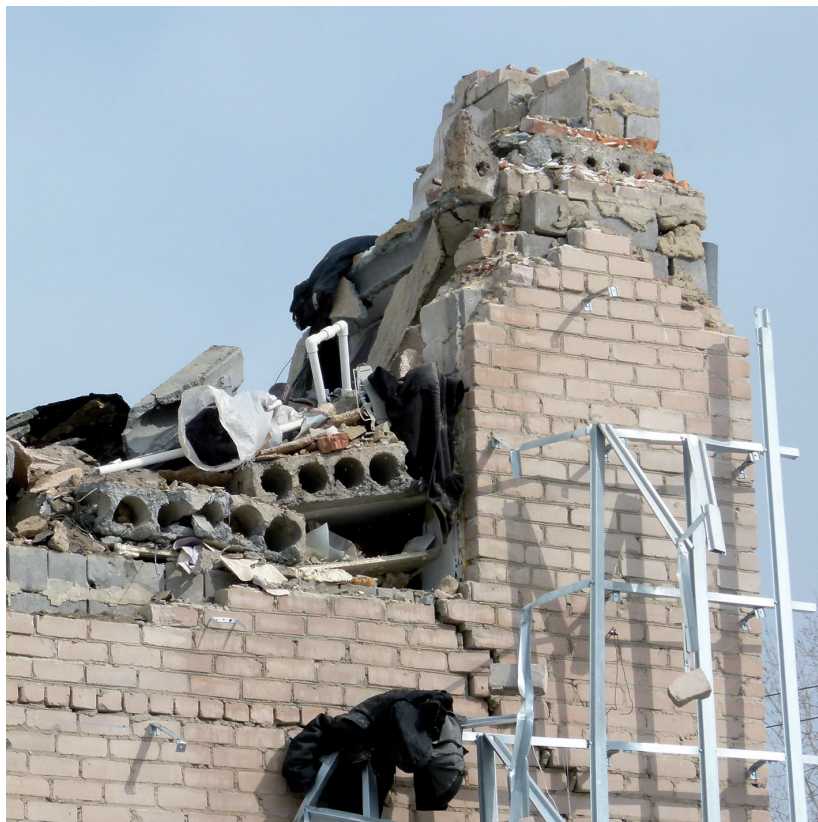
Рис. 5.20. Трещины в стенах
