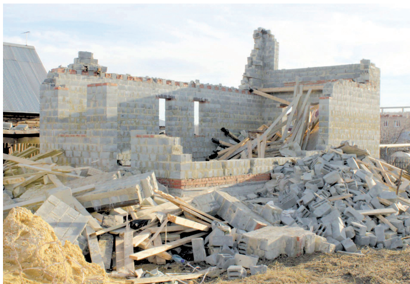
Рис. 5.22. Разрушенный дом по ул. Логовой
