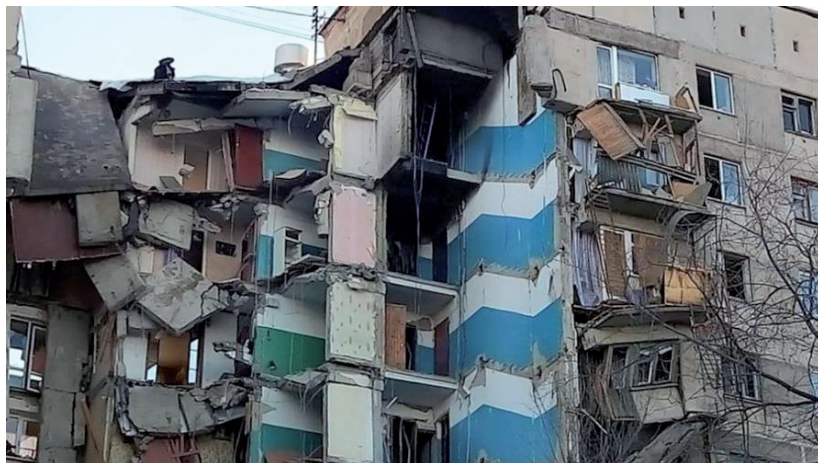
Рис. 6.2. Нависшие конструкции, создающие опасность для работы спасателей
